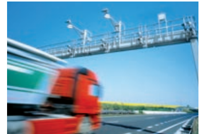
Elektronische Gebühren-/Mauteinhebungssysteme für den mehrspurigen Fließverkehr (multi-lane free-flow – MLFF ETC systems)
